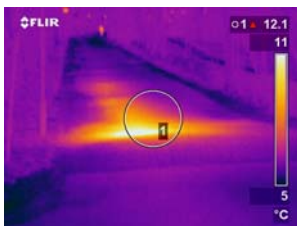
Billedet viser varmeudvikling pga. lækage på fjernvarme ledning.
